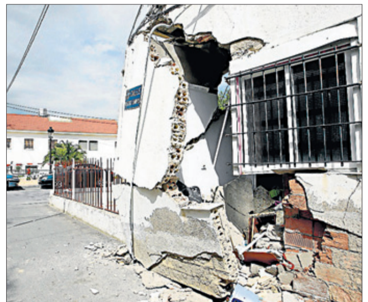
Estado en el que ha quedado una vivienda de Lorca. JUAN CARLOS CÁRDENAS
