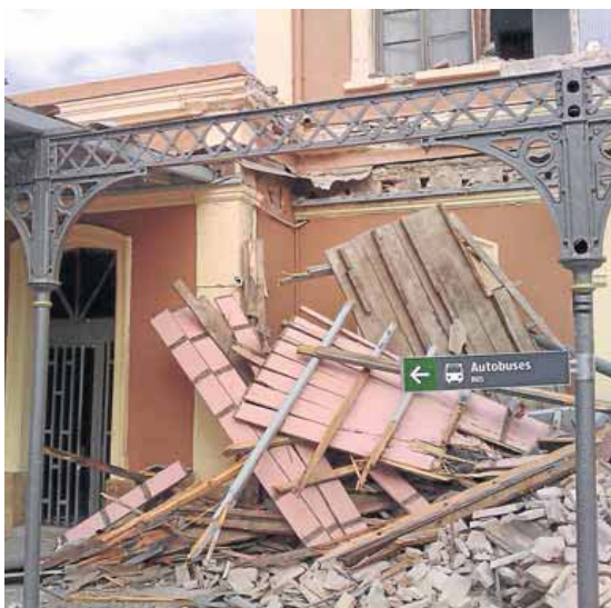
● Estación de Lorca tras el reciente terremoto. LA VOZ
