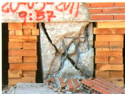
Pilar corto roto en Lorca
