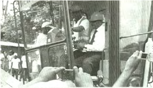
Le ministre délégué à l'Équipement, Jean Richard Sylong, lançant les travaux de réhabilitation de la route Popa/Koula-Moutou.
